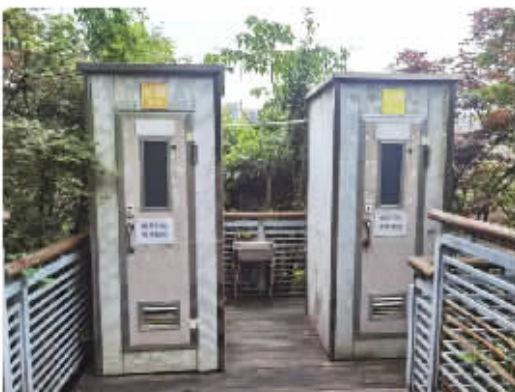
龙泉山半山腰的移动公厕损坏停用
