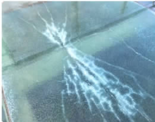
泉湖公园玻璃栈道上的部分玻璃开裂,存在安全隐患
