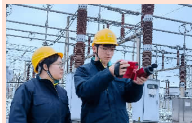
工作人员在变电站开展巡视
