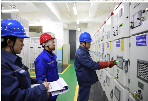
工作人员在贵阳北站“体检”用电设备
