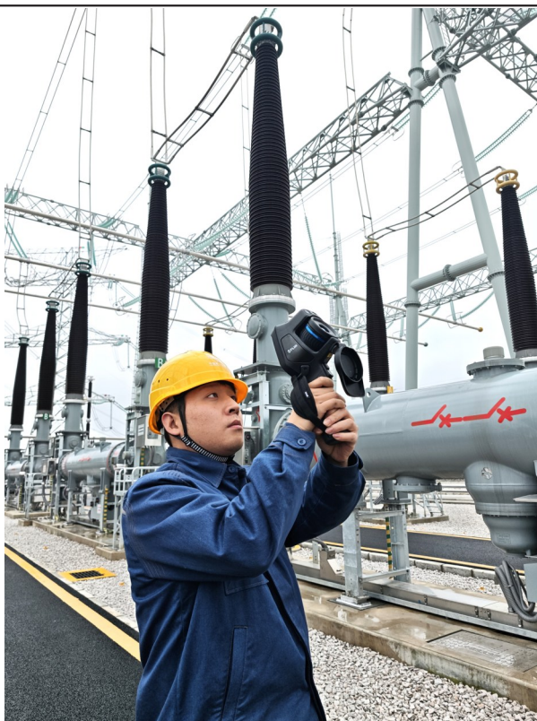
工作人员在变电站开展巡视
