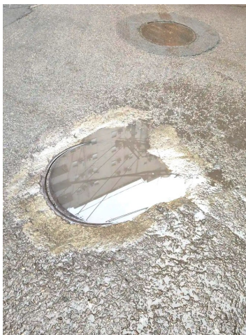
交通街井盖溢出污水
