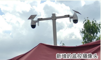
新增的监控摄像头
