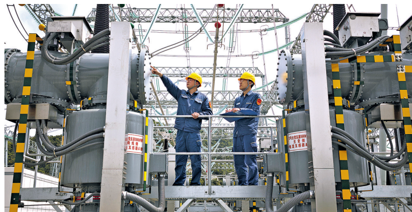
3月26日，技术人员排查500千伏马场变电站主变压器等核心设备状态，为正式投运做准备。
